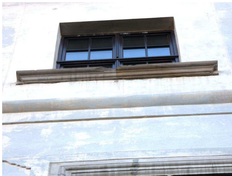
Fot. 10 Parapet podokienny P.O.2.1. Widoczne rozległy ubytek w strefie środkowej.
