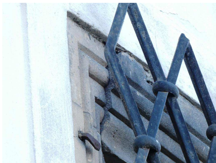
Fot. 9 Okno O.O.2.4 Widoczne przemieszczenie uszkodzonego fragmentu nadproża
