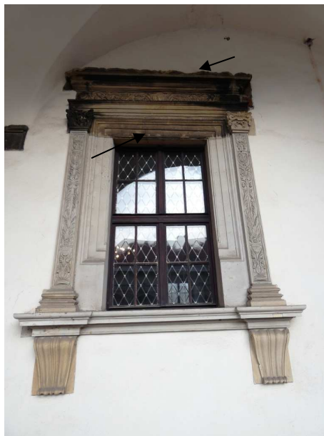
Fot. 13 Elewacja E8. Okno O.O.12.2. Widoczne osmolenie lica , liczne ubytki gzymsu nad- okiennego oraz spękanie nadproża „zachowanych” fragmentów kamieniarki. Części nowowbudowane w dobrym stanie.
